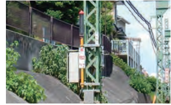
▲落石検知装置
