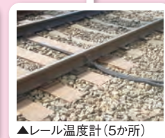
▲レール温度計(5か所)
