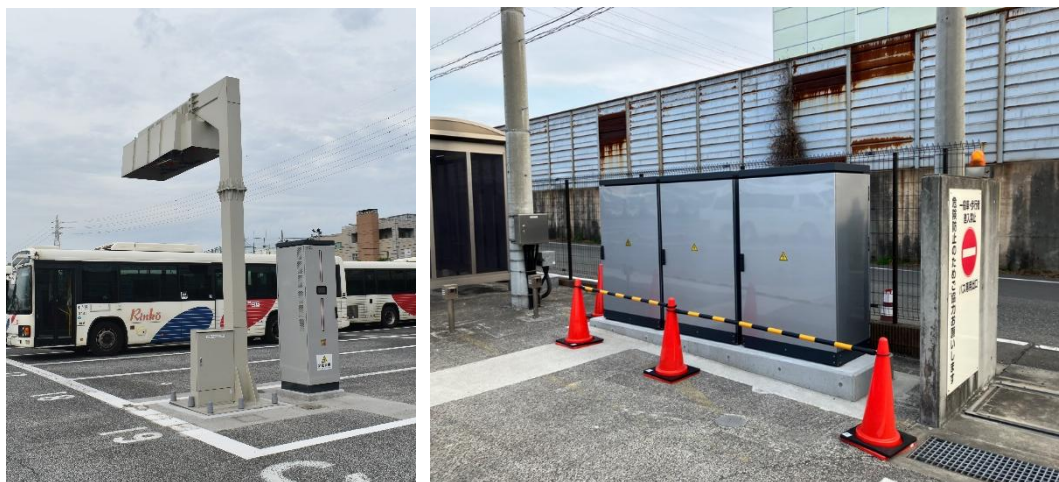
(左) Drive Electro Technology 製パンタグラフ式充電器
