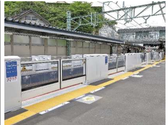
<設置例(追浜駅下りホーム)>
