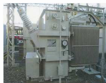
川崎変電所 高配用変圧器
