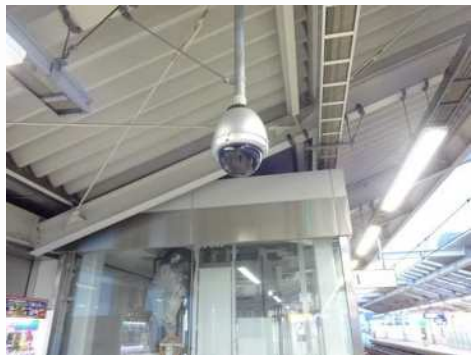
駅監視カメラ設置例 (全駅設置済)
