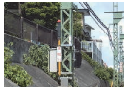
▲落石検知装置
