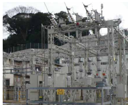
▲久里浜変電所 受電設備
