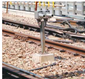
▲障害物検知装置
