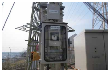
▲南太田変電所 特別高圧充電判別装置
